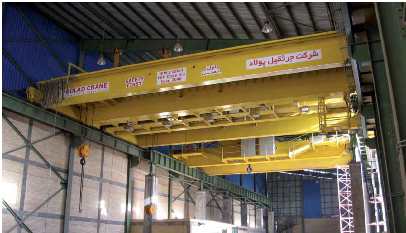
Roll Shop – Cranes 35/15 Ton
